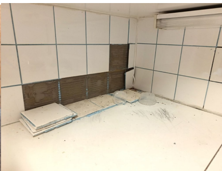
Irronneita keittiön kaakeleita
