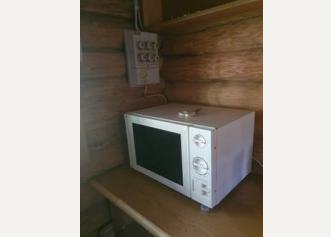
keittiön sähkötaulu ja mikro
