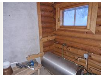
sauna/ph lämminvesivaraaja ja laudepaikka
