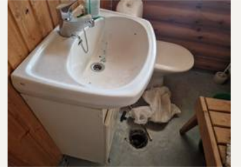
Wc-saunan pukuhuone lattiakaivo
