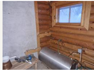
sauna/ph lämminvesivaraaja ja laudepaikka
