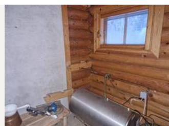
sauna/ph lämminvesivaraaja ja laudepaikka
