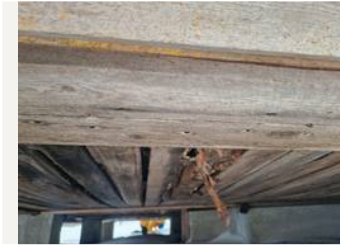
WC-saunan pukuhuoneen rossipohjan vuoto/korjaustarve
