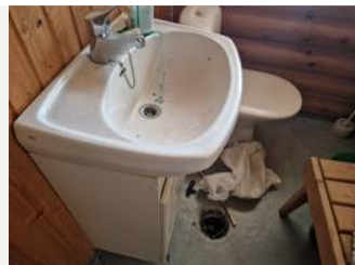
Wc-saunan pukuhuone lattiakaivo
