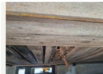
WC-saunan pukuhuoneen rossipohjan vuoto/korjaustarve
