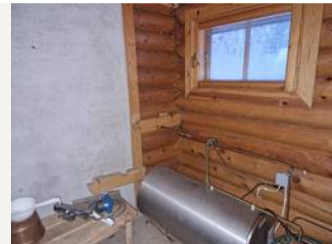
sauna/ph lämminvesivaraaja ja laudepaikka
